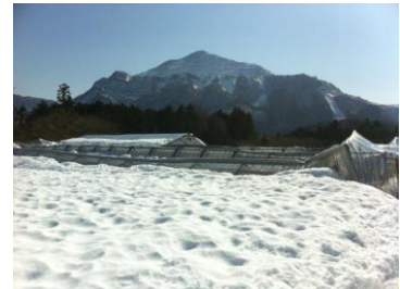
倒壊した大型鉄骨ハウス
