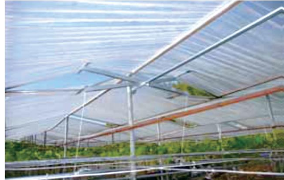
▲天井ビニール開閉装置
