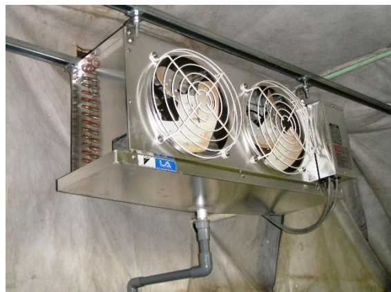
写真3 既存貯蔵庫に追加した冷却装置
