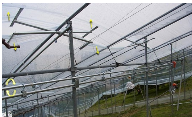
▲天井ビニール開閉装置
