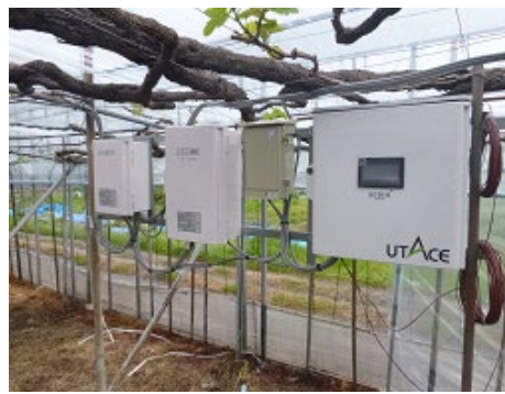
▲府内初導入の高性能開閉制御装
