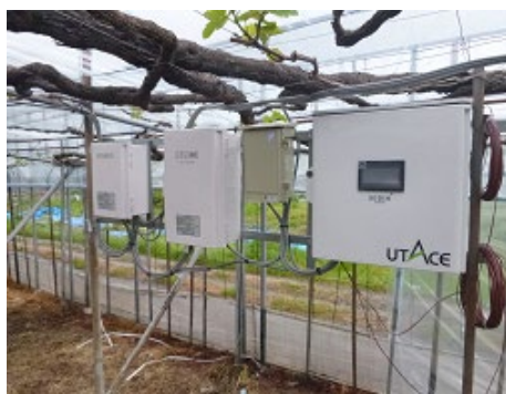
▲府内初導入の高性能開閉制御装
