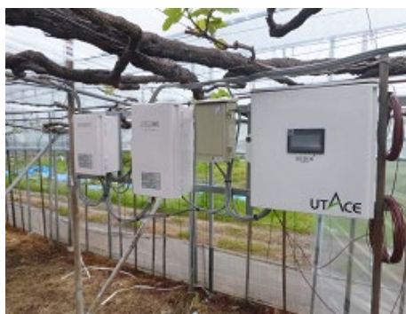
▲府内初導入の高性能開閉制御装
