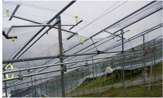
▲天井ビニール開閉装置
