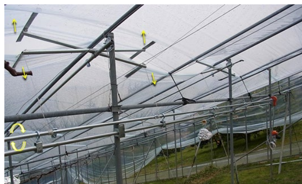
▲天井ビニール開閉装置
