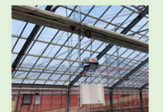
日射測定装置設置状況
