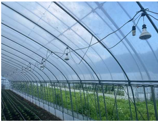
写真3 UV-B LED 設置の様子
