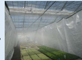
ヒートポンプとミスト、仕切りを利用した冷却の様子
