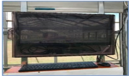
統合環境制御装置
