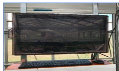
統合環境制御装置
