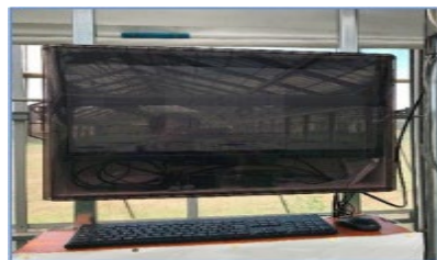
統合環境制御装置
