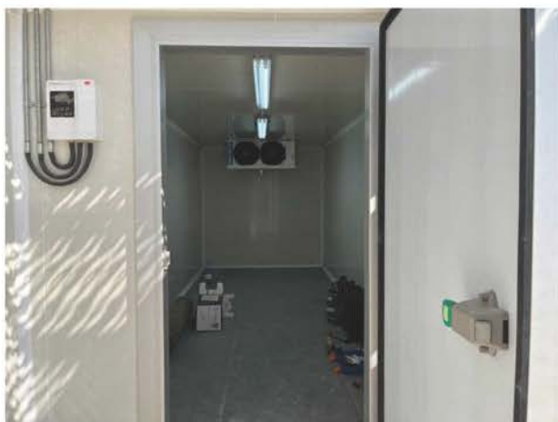
保冷コンテナ内部
