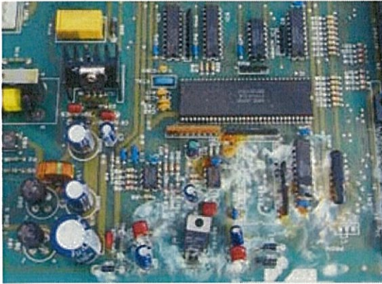
操作盤(基板が塩水に浸かった跡)
