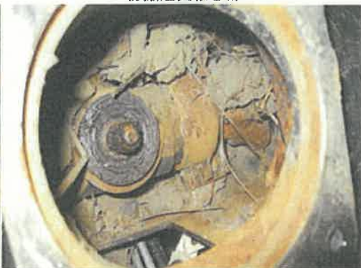
粉搬送受継ぎ部
