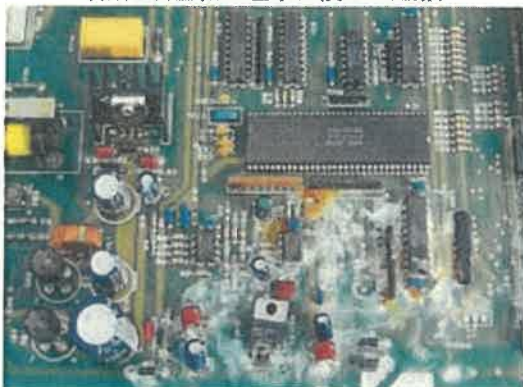
操作盤(基板が塩水に浸かった跡)
