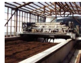
税制対象設備の例:堆肥化処理施設
