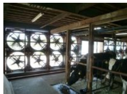
トンネル換気システムの導入
