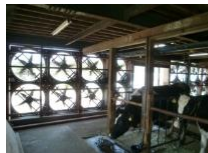
トンネル換気システムの導入
