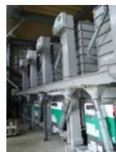
穀類乾燥調製施設
