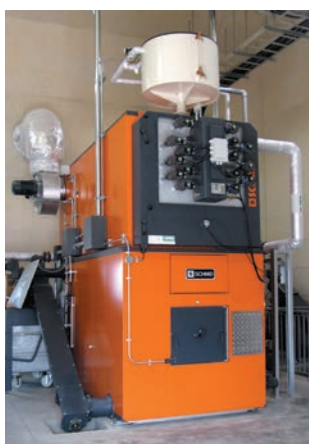
木質チップボイラー
