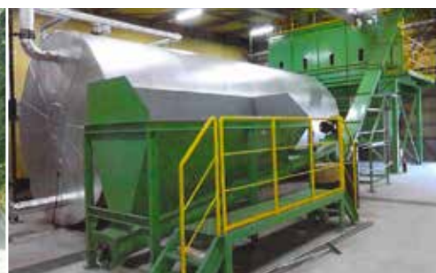
木質バイオマスボイラー
