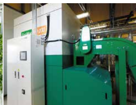
木質チップボイラー
