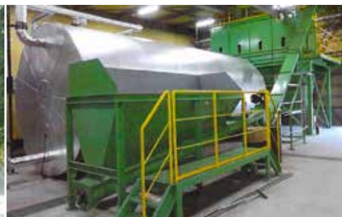
木質バイオマスボイラー
