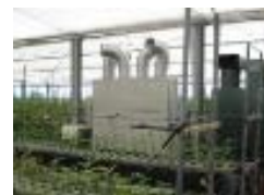
ヒートポンプ
