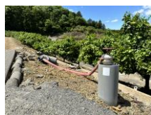
かん水設備による 安定生産
