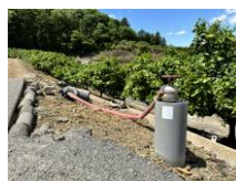
かん水設備による 安定生産
