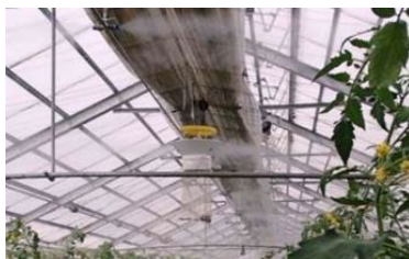
細霧冷房装置
