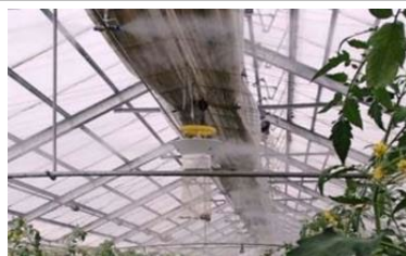
細霧冷房装置
