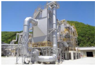
燃焼・熱回収設備の外観
