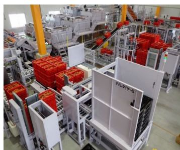
人参洗浄選別施設
