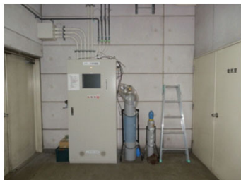
エチレン濃度制御装置
