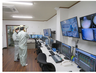
中央制御化設備
