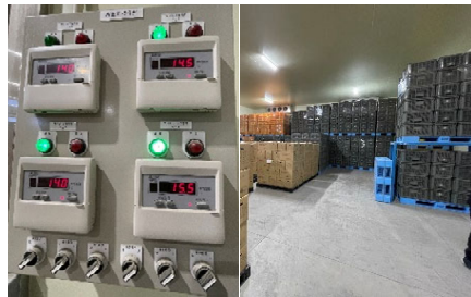
定温貯蔵設備
