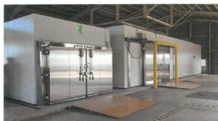
貯蔵用高湿度冷蔵庫
