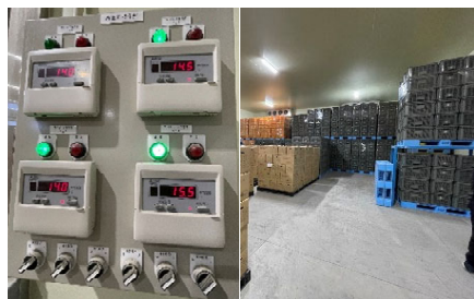
定温貯蔵設備
