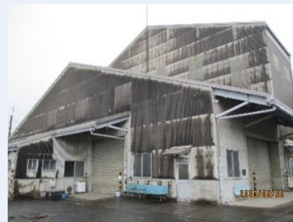
老朽化した施設
