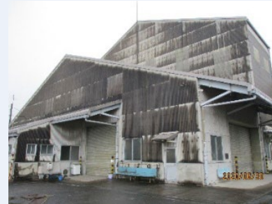
老朽化した施設
