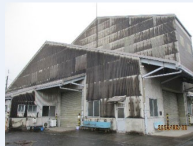
老朽化した施設
