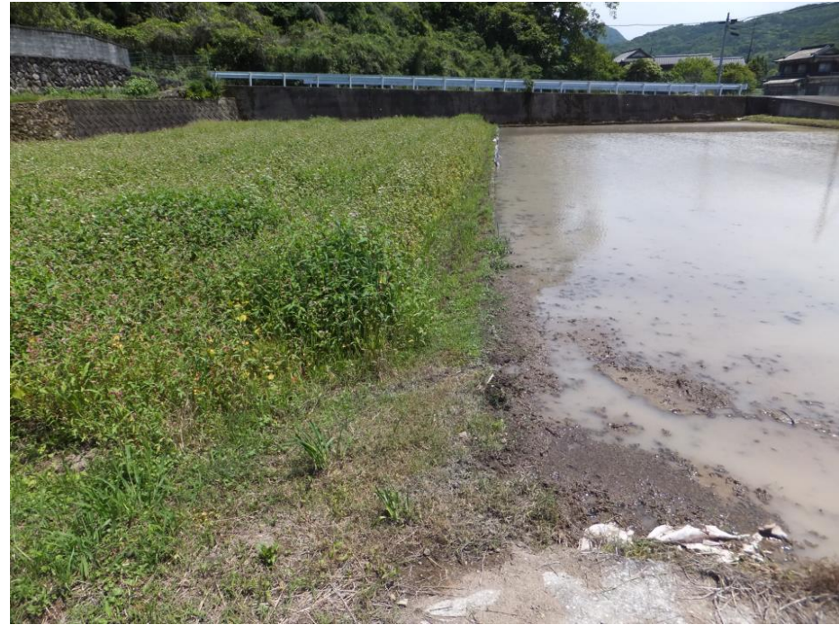
隣接水田からの漏水
