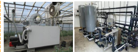
省エネ機器（木質ボイラー、ヒートポンプ等）
