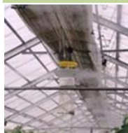
細霧冷房装置の設置
