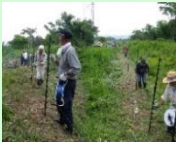
《電気柵設置の様子》
