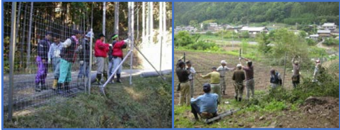
田畑への侵入を防ぐ取組(柵の設置)
