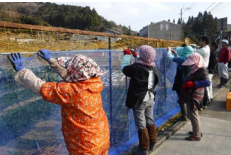
「電落くん」設置の様子
