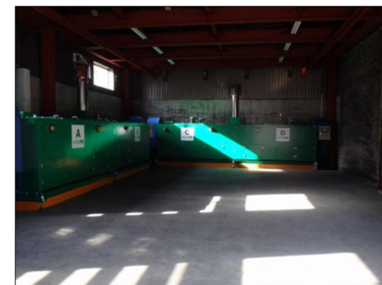
分解処理装置（外観）
