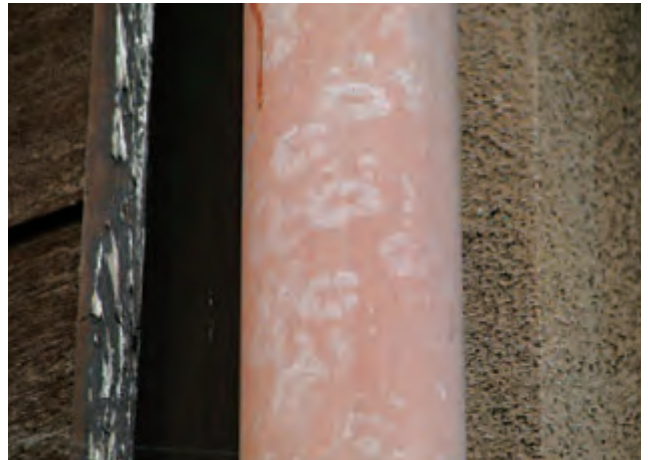
雨樋に残された足跡
