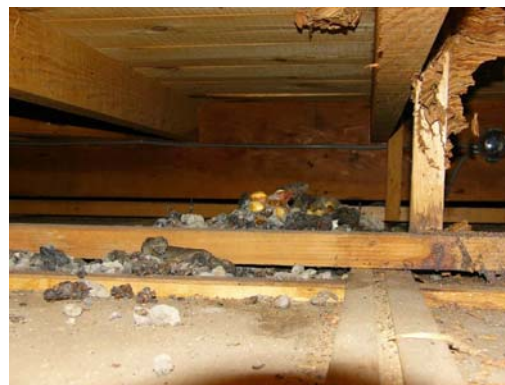
天井裏のフン被害
