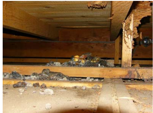
天井裏のフン被害
