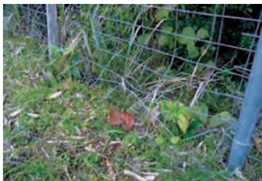
写真2-2-2 管理が不十分な侵入防止柵の例
