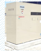
バイオガス発電設備
