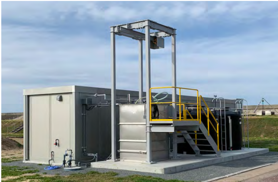
築上町濃縮バイオ液肥小型プラント
